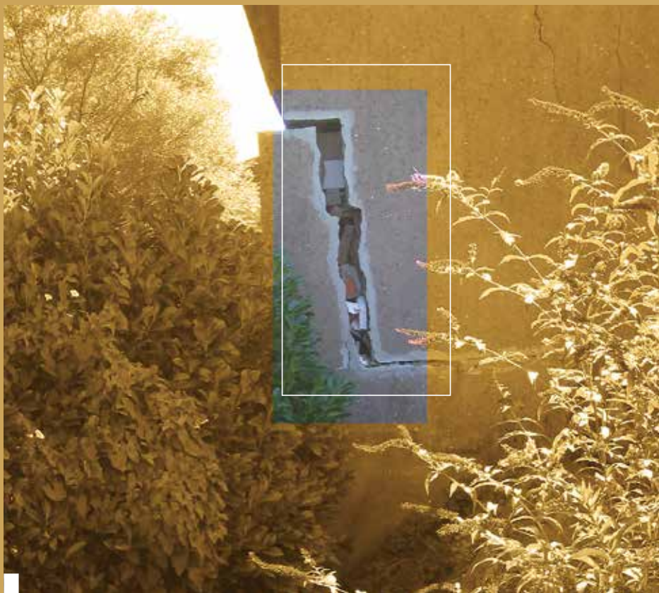
Fissure provoquée par affaissement de terrain
